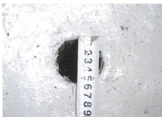
写真6 左の写真の NS スイパーをドレンパイプに差し込むだけです
